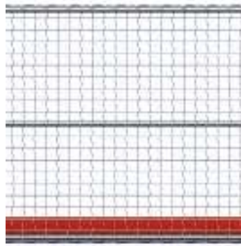
Red de protección lateral sin cintas de amarre
